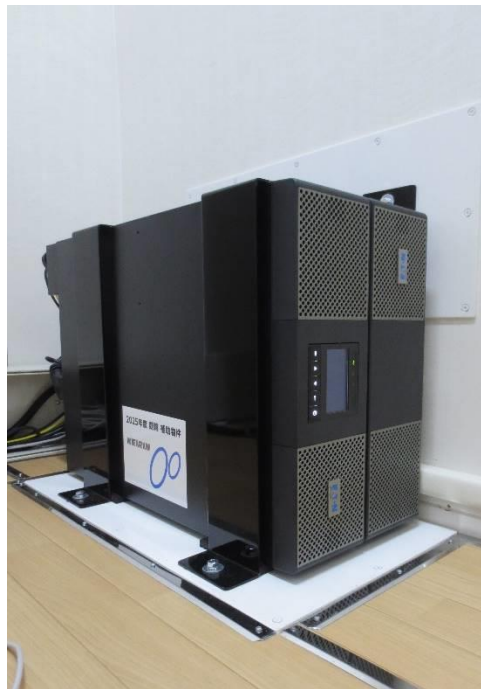
1 - ii 撮影装置用無停電電源装置(UPS)
