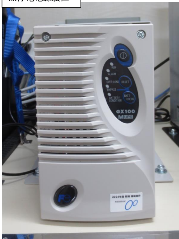
無停電電源装置
