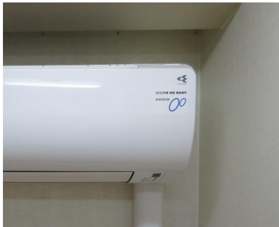
4- i 超音波検査室ルームエアコン
