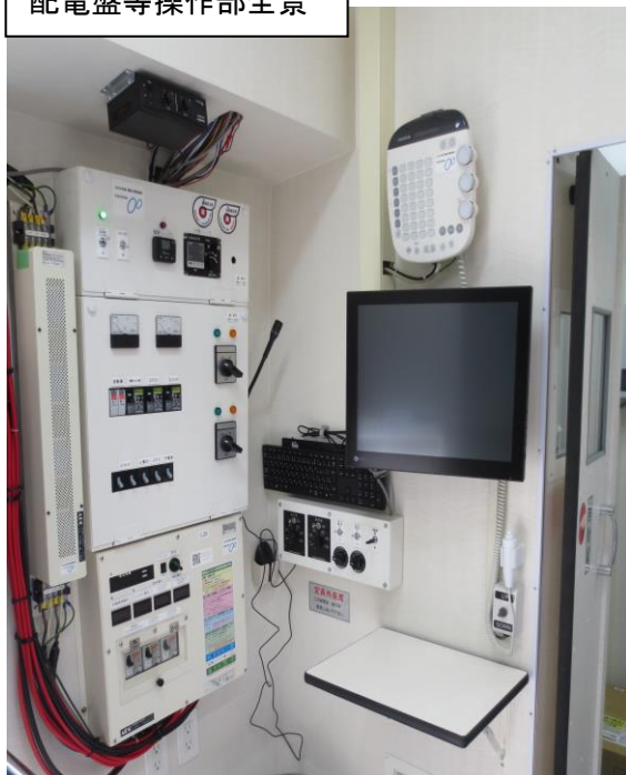
配電盤等操作部全景
